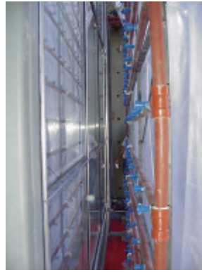
Rejilla rociadora (caudal)
